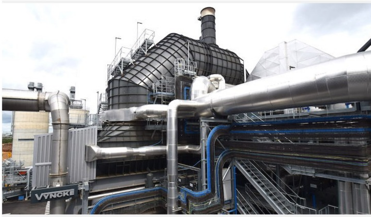
Le haut de la chaudière de 65 MW, photo Frédéric Douard
