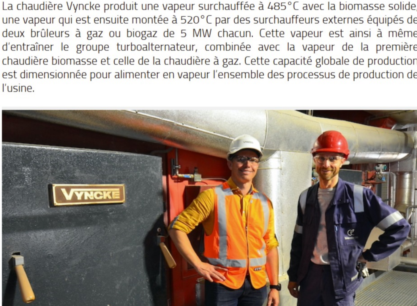
L'un des deux brûleurs à gaz ou biogaz sur la chaudière Vyncke, photo Frédéric Douard
